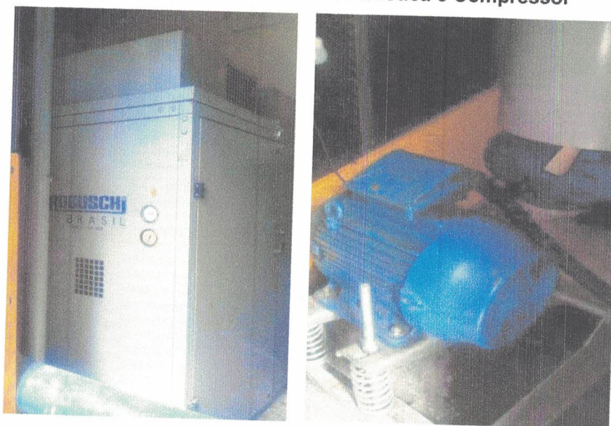
Figuras 42 e 43 – Cabine Acústica e Compressor
