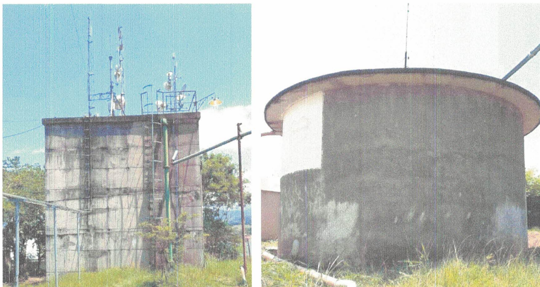
Figuras 28 e 29 – Reservatórios próximo da ETA Bondarovsky
